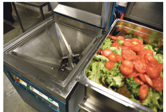
Kværnen som den ser ud installeret på Bispebjerg Hospital.
